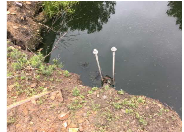
STP2 Outlet to M1
